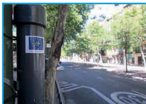
Figura 59: Detalle de sensor instalado en zona de aplicación del tratamiento superficial fotocatalítico. Fuente: Cartif.
