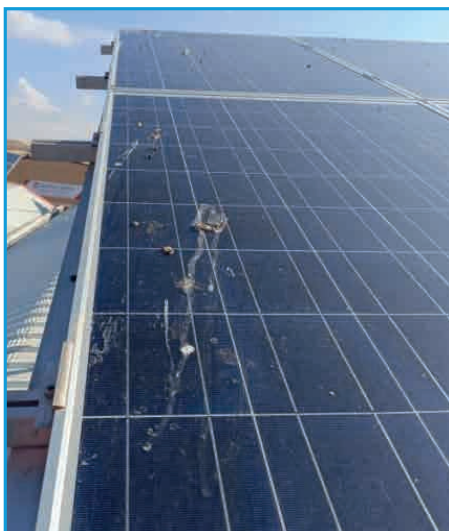
Figura 123: Ejemplo de estado de conservación de panel fotovoltaico, antes de la limpieza. Fuente: Biorisk.
