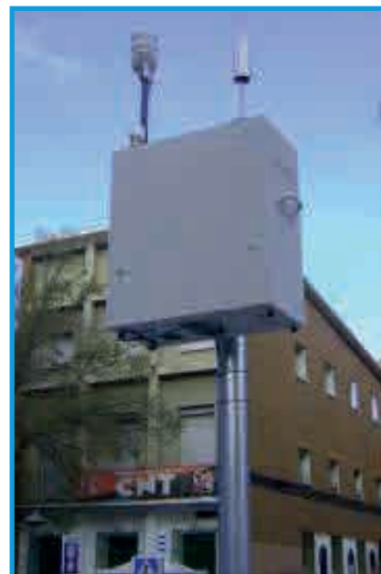
Figura 54: Analizador automático en continuo para la determinación en el aire ambiente de óxidos de nitrógeno ( NO , NO_2 , NO_x ) y de ozono ( O_3 ) puesto en la plaza de Ágata. Fuente: Eptisa.
