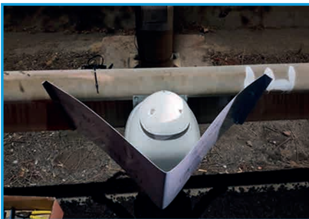
Figura 8.A: . Estación de calidad del aire instalada en la Autopista C-31 para seguimiento de eficiencia fotocatalítica. Fuente: Fundación Cartif.
