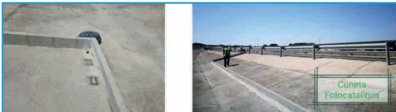
Figura 87: Cuneta fotocatalítica con incorporación de muestras testigo en el hormigón. Fuente AIF.
