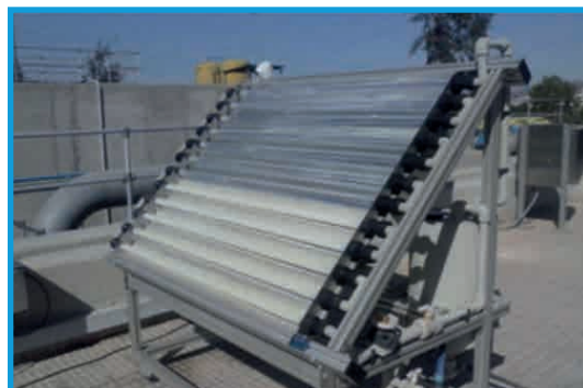
Figura 41: CPC instalado en la EDAR de Beniel en Murcia.
